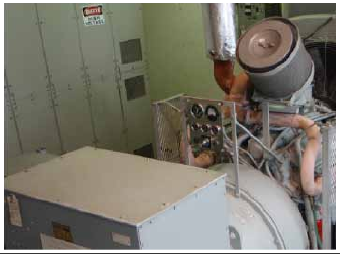
Şekil 3-7. Dizel elektrik jeneratör grubu (kaynak: Toronto Uluslararası Havalimanı)
